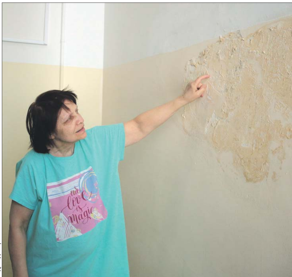
Жительница нижней квартиры Любовь показывает протечку на стене
