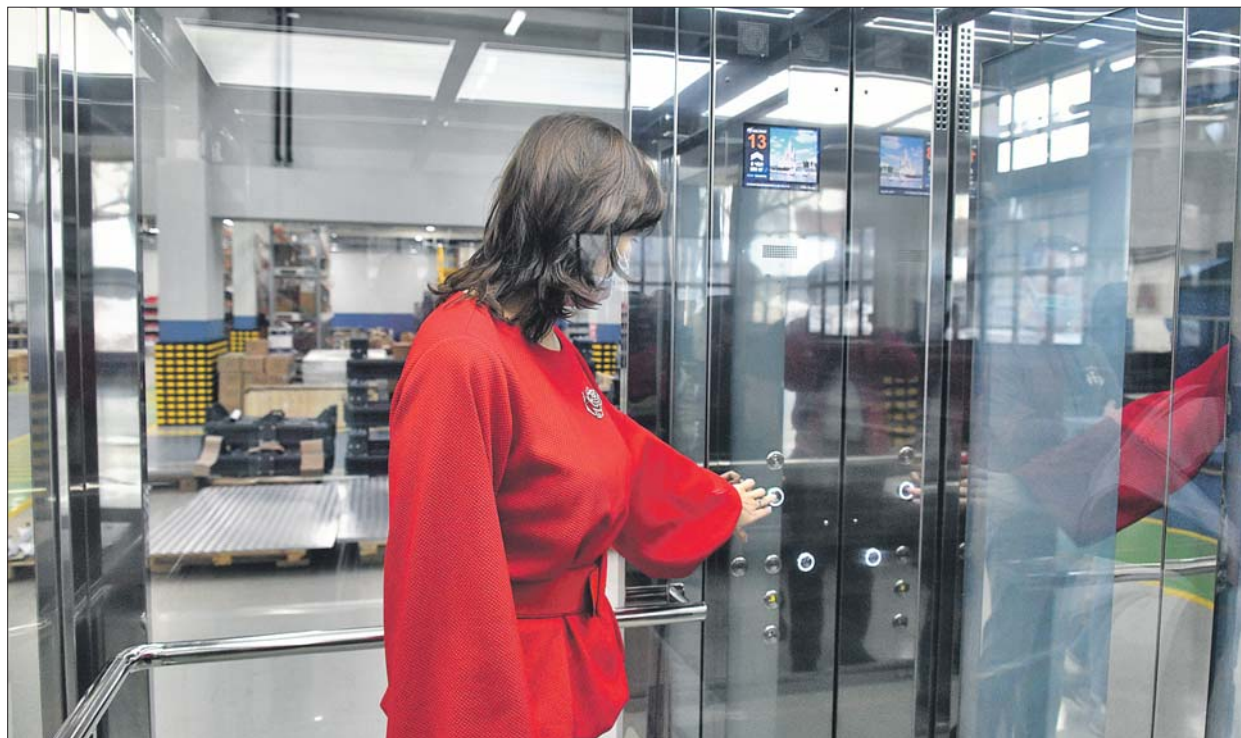
Одна из демонстрационных кабин, которая стоит в производственном цехе. Это панорамный лифт, их обычно устанавливают в торговых или бизнес-центрах
