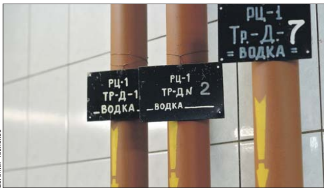
Водочный трубопровод в цехе расфасовки
