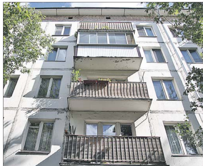
Дом 118/7 на Волгоградском проспекте рассчитан на длительный срок эксплуатации и подлежит ремонту
