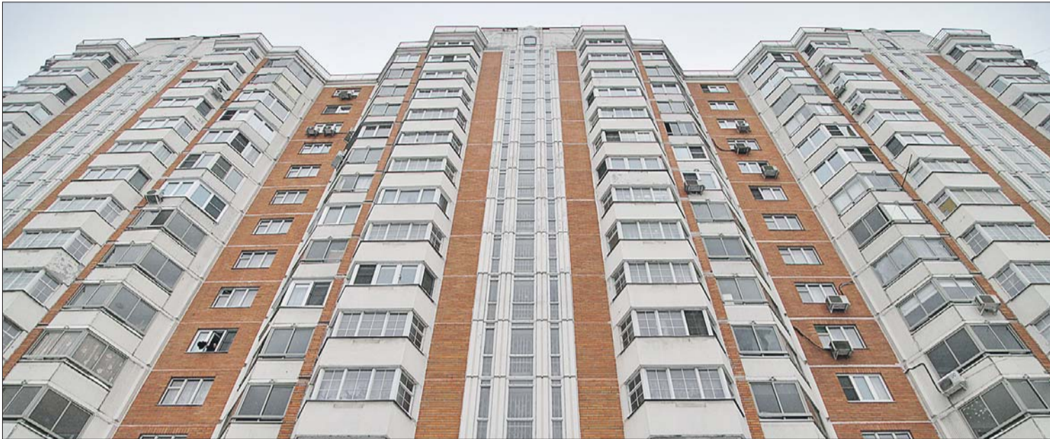
Дом 17 на 3-й Институтской построен в 2002 году, но его состояние уже требует ремонта
